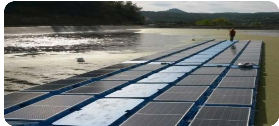
Pasarela de mantenimiento del sistema
