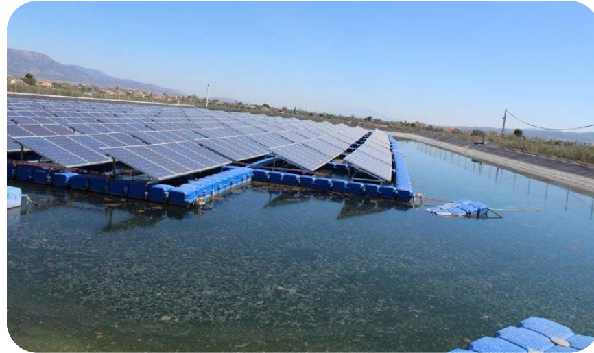
Vista aérea de la plataforma fotovoltaica
