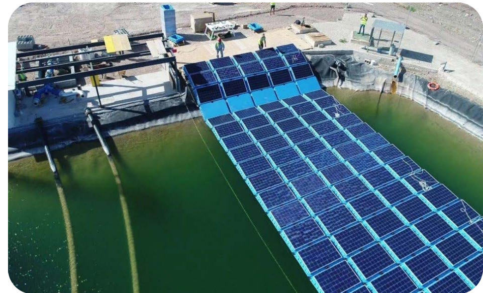
Vista aérea de la plataforma fotovoltaica
