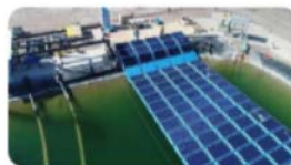
Proyecto de plataforma fotovoltaica flotante sobre balsa de riego de uso agrícola
